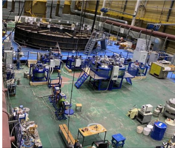
Комплекс ВПП электроизоляции обмоток
